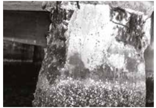
Figura 1. Elemento de concreto reforzado dañado por acción del agua de mar.
