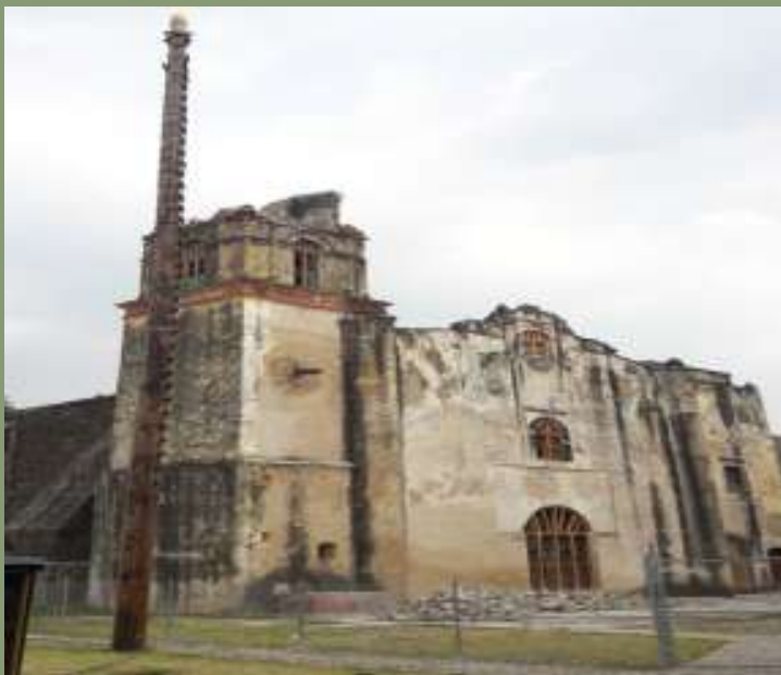
Fotografía 3. Iglesia después del sismo del 19 de septiembre de 2017
